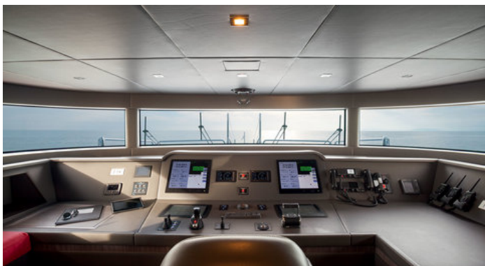
Главный пост управления
